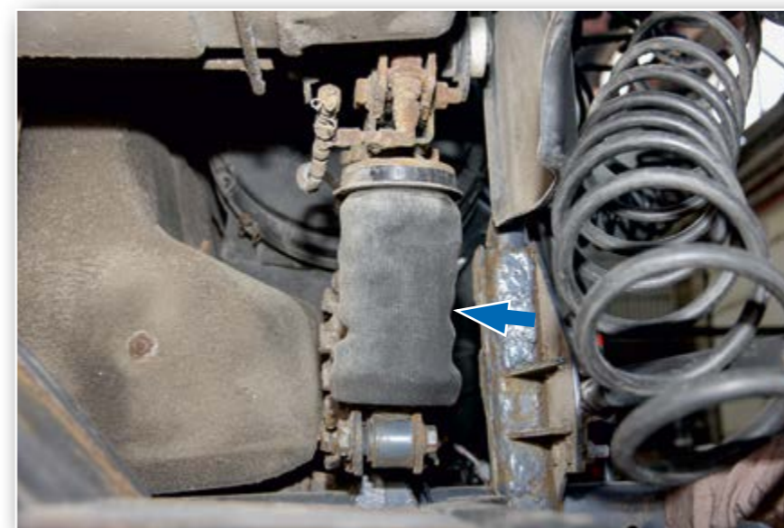
Выход из строя элементов подвески кабины приводит к ее раскачиванию и провоцирует износ шин рулевой оси
